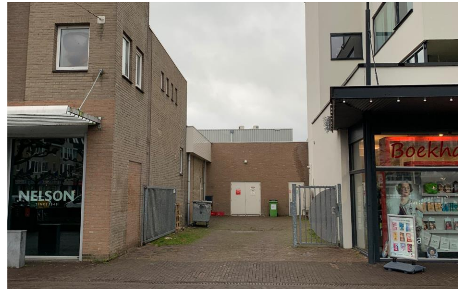
Storend gat in de gevel
