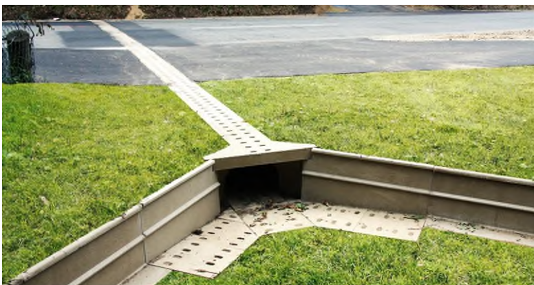
Figuur 25: Amfibietunnel onder een weg (bron: ACO)
